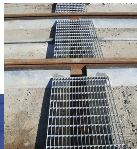
PASSERELLE COMPOSÉE DE CUVETTES COLLECTRICES
